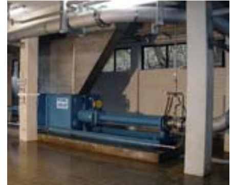
Spezial-Pumpe für entwässerten Klärschlamm: Zentralkläranlage Pöfing, Wangen • Special pump for dewatered sewage sludge
