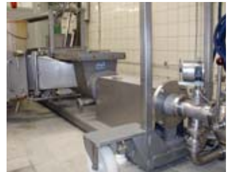
Edelstahlpumpe für Schmelzkäse: Bel Deutschland, Wangen Pump in stainless steel handling melted cheese
